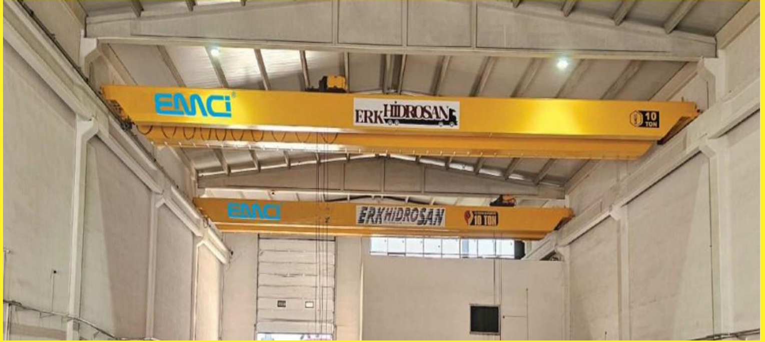
Çift Kirisli Köprülü Vinçler (Vinç Taşıyıcısı)
